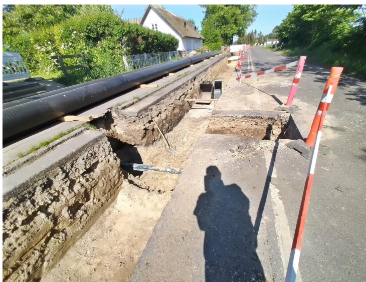
Kirkebakken 40, på billede ses vandleddningen, skal "sænkes"
