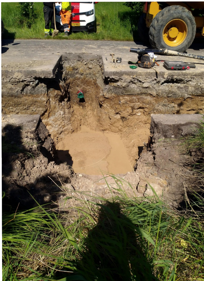
På billedet ses vandledningen der skal sænkes. Vandet fra lækagen er endnu ikke blevet pumpet bort.
